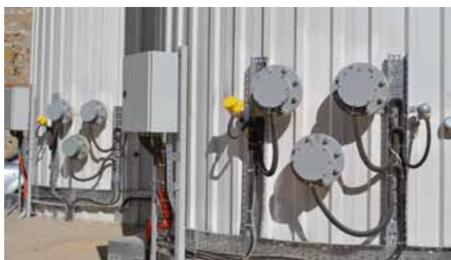
Система электрообогрева битумной емкости Electrical tank heating system
