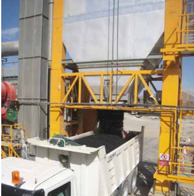
Бункер готовой смеси, 85 тонн 85 tons Hot Mix silo
